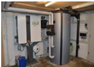
Speicher mit Warmwassertank
